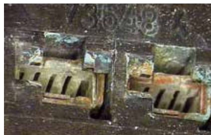
Empalme con humedad y restos de corrosión
