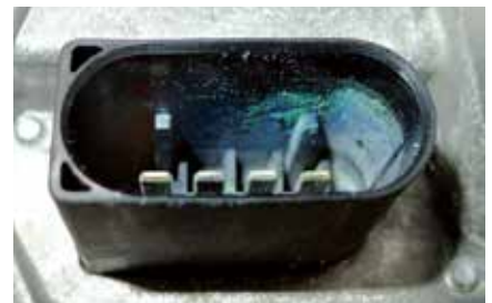
Connecteur présentant des traces de corrosion
