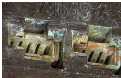
Raccord présentant des traces d'humidité et de corrosion
