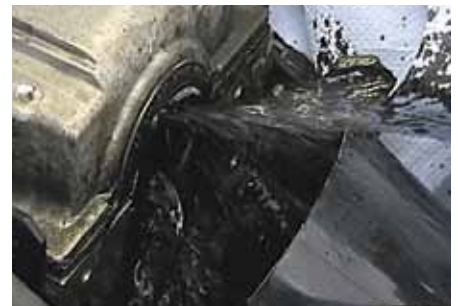
Atención: si el abastecimiento de aceite lubricante es correcto, pueden fluir por aquí entre 30 y 60 litros por hora.
