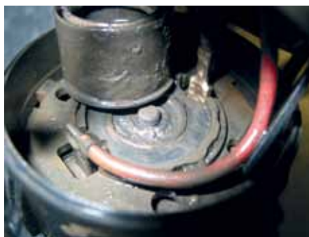
Agresivní kondenzát spalin v hnacím motoru čerpadla sekundárního vzduchu
