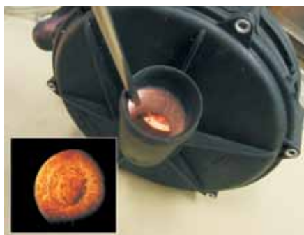
Pohled do zkorodovaného přívodu čerpadla sekundárního vzduchu
