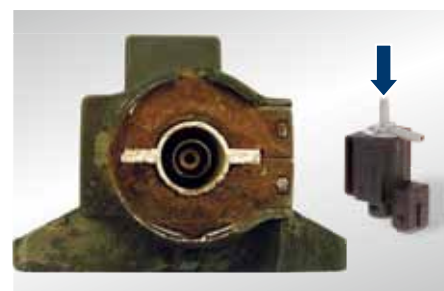
Korroderet el-omkoblingsventil (åben)
