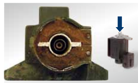
Elettrovalvola di commutazione corrosa (aperta)
